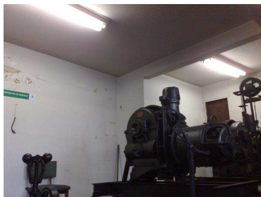
Foto 15 – Casa de Máquinas; notar trinca entre a parede e a viga de cobertura
