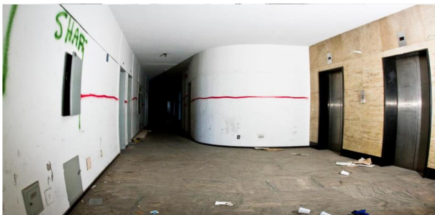
Figura 11 - Instalações dos shafts no hall do Excelsior Residence
