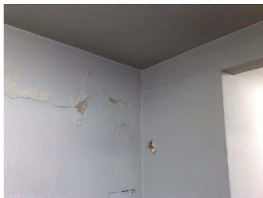
Foto 16 – Trincas na face inferior da viga – provavelmente devido à dilatação térmica
